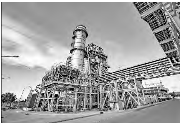
▲ Planta termoeléctrica de ciclo combinado en Tula, Hidalgo. Foto cortesía de la Comisión Federal de Electricidad
