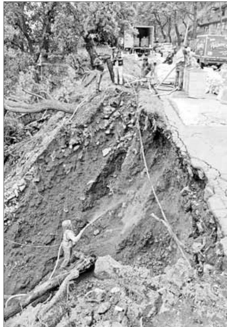
▲ Las lluvias de la semana pasada acentuaron el deslizamiento de tierra en un tramo que delimita las alcaldías Xochimilco y Milpa Alta. Se prevé que los trabajos duren un mes. Foto La Jornada
