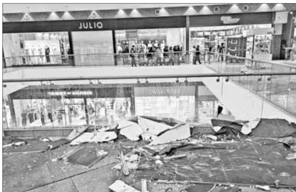
▲ La fuerte lluvia de ayer en la capital provocó el desprendimiento de plafones en el centro comercial Parque Lindavista, en Gustavo A. Madero, sin reporte de lesionados.
