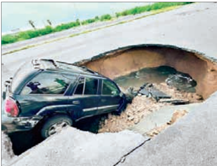
▲ Un hombre de la tercera edad estuvo a punto de perder la vida cuando la camioneta que conducía cayó en un enorme socavón en la calle 15 de Septiembre, casi esquina con Prolongación Guerrero, en Nuevo Laredo, Tamaulipas. Foto Carlos Figueroa
